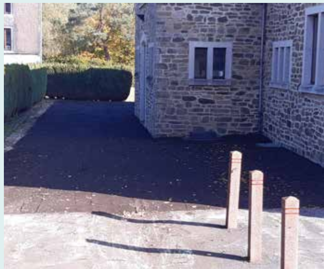
Réfection du parking de l'école d'Opont. Terrassement, mise en place d'une bâche anti racine et raclage.
